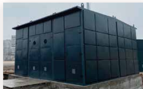
Стадион ВРЗ, г. Днепр Производство, поставка и монтаж ТП (10кВ) РП-10кВ выполнено на компактных ячейках Xiria
